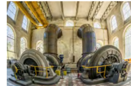
Centrale hydroélectrique Les Vernes, classé monument historique en 1994. Fin d'activité en 2020.
